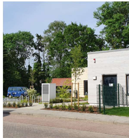
Luftwärmepumpe mit Außeneinheit
