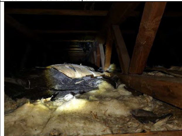
27 Blick in den Dachstuhl aus Blickrichtung der Lücke in der kaputten Decke von Foto 25
