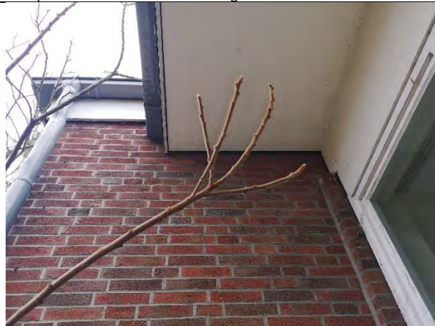
15 Spalten zwischen Überdachung und Traufe bzw. Wand
