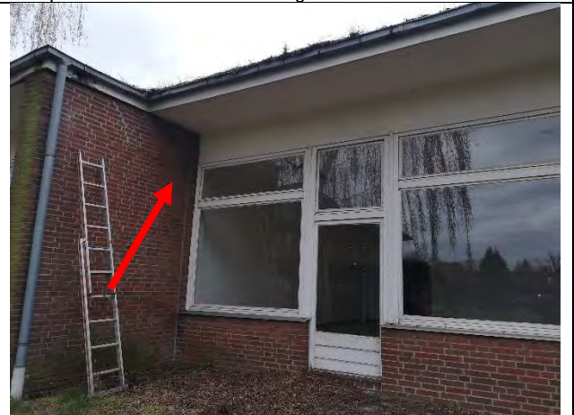
16 Nische mit Rissen in der linken Wand und Spalte zwischen dem Fensterrahmen und der Wand -> nachgewiesene Fledermausquartiere (s. Kapitel 4.1.1.3)
