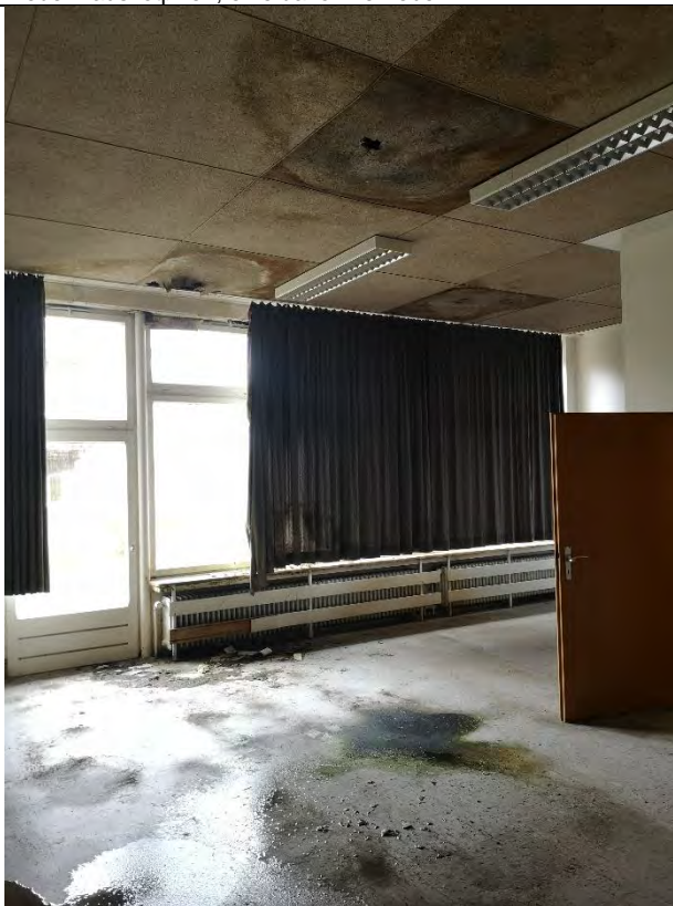
23 undichtes Dach in einem der Räume auf der Südseite
