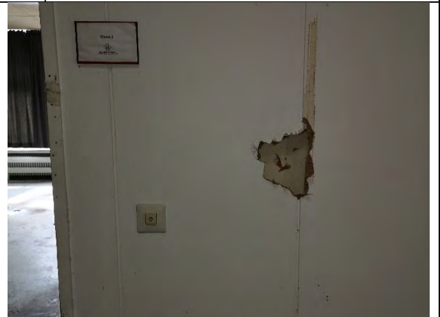
34 kaputte Wand im Flur
