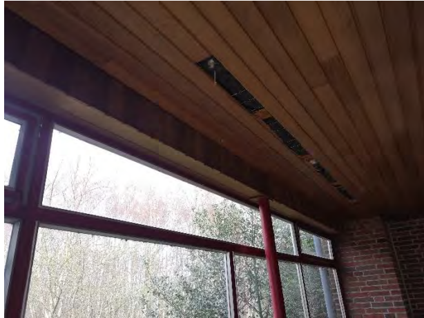
31 kaputte Decke im Bereich des Haupteingangs
