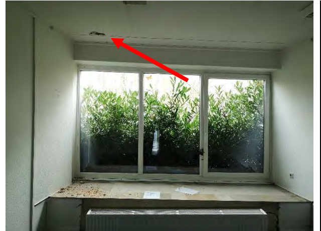
32 kaputte Decke in einem der Räume im Norden
