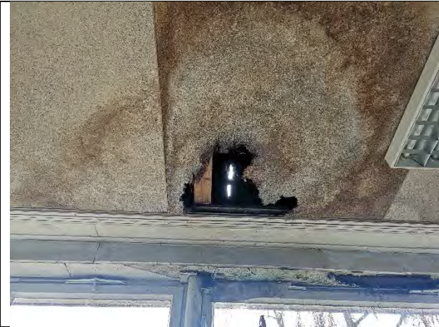
25 Detailbild von Foto 24 mit Durchsicht vom Inneren des Hauses in den Himmel durch das kaputte Dach
