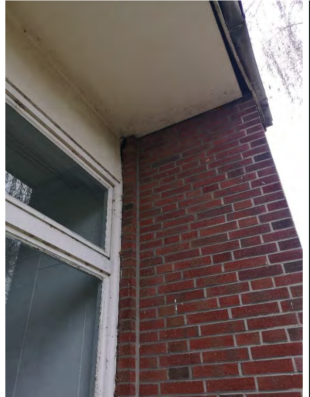
14 Spalten zwischen Überdachung und Traufe bzw. Wand
