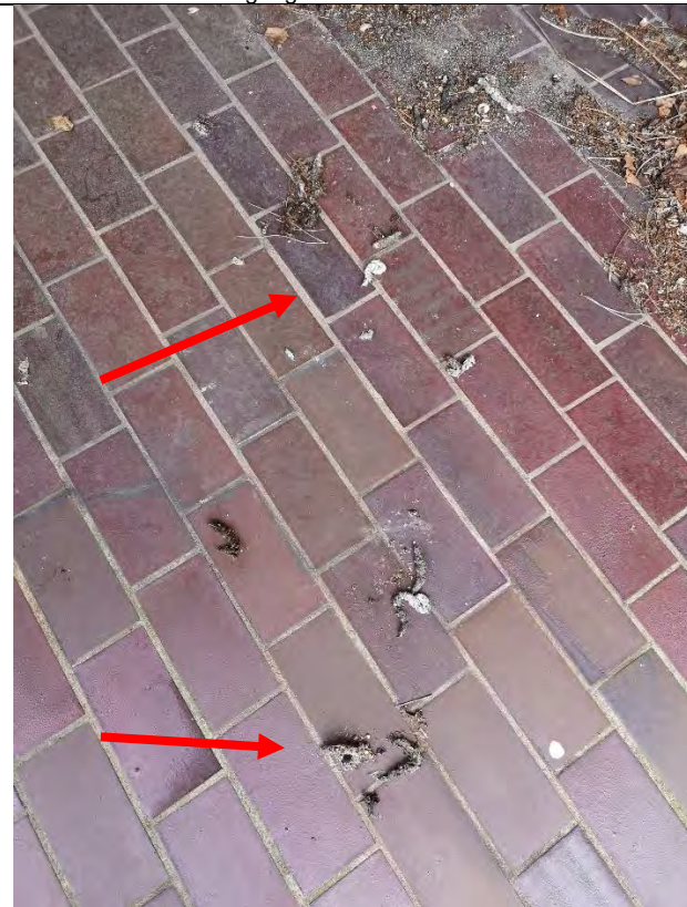
9 Steinmarderkot unter dem kaputten Vorbau vom Nebeneingang auf der Nordseite
