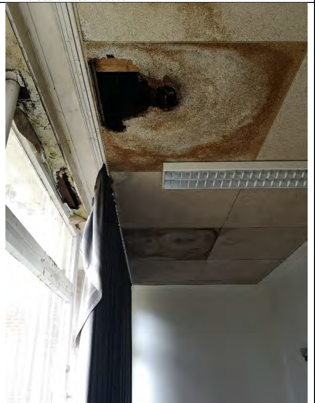
24 Detailbild von Foto 23 mit Wasserschaden in der Deckenverkleidung
