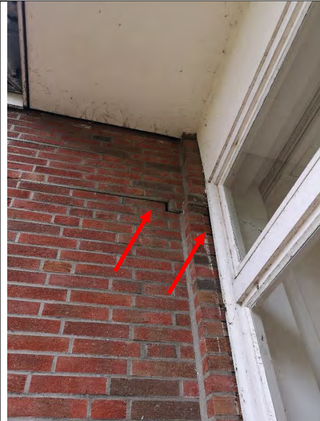
17 Detailbild von Foto 16 mit Rissen in der Wand und einem Spalt zwischen dem Fensterrahmen und der Wand -> nachgewiesene Fledermausquartiere (s. Kapitel 4.1.1.3), die Pfeile markieren die Orte, wo die Tiere eingeflogen sind Detailbild von Foto 16 mit Rissen in der Wand
