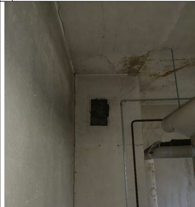
29 offene Wartungsöffnung für den Schornstein
